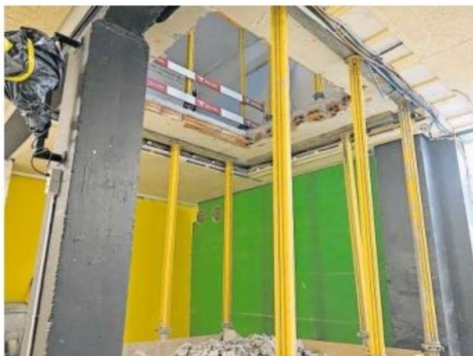
Der Lift führt durchgehend vom Keller bis ins oberste Geschoss.
